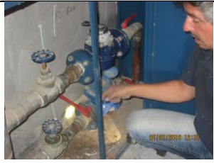
Figura 1. Revisión de la red de agua potable y gestión de los consumos en módulos.
